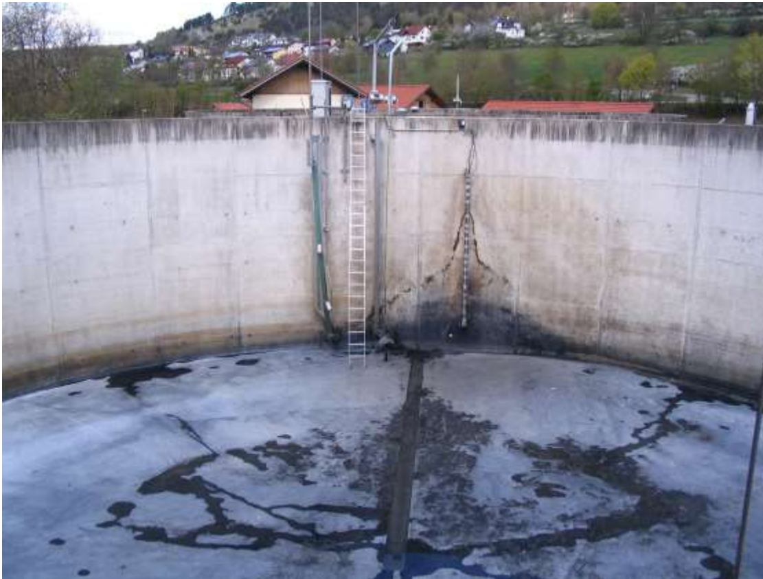
Klärschlammbehälter nach der Entleerung
