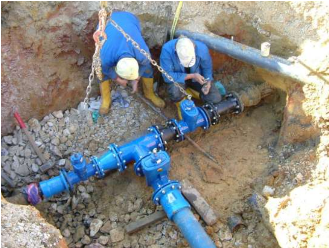
Kapital im Untergrund – Schieberkreuz der Wasserversorgung
