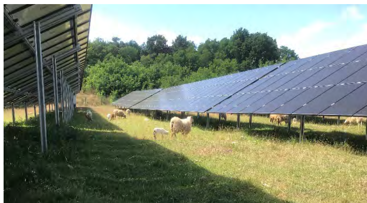
Abbildung 6: Extensive Schafbeweidung im Solarpark
